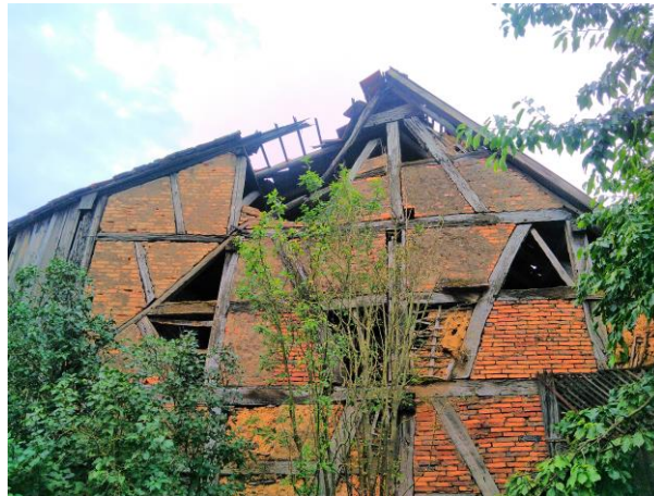
Foto 11.: Ein Blick auf den anbrüchigen Giebel der Nordwestseite von Gebäude Nr. 5 lässt die hohe Gefährdungslage erahnen.
